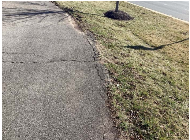
Walking path edge deterioration
